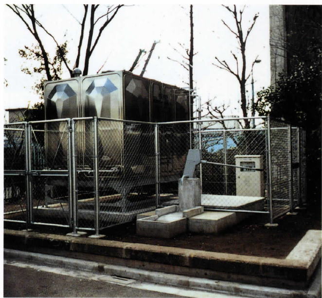
防災用2連式井戸設置状況（東京都内）
